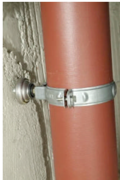
Figur 5. Gustavsberg Rörsystem MA-dämpare skruvad i stift i vägg och mot standard klamsvep (bilden tagen av leverantören). Rörligheten mellan klamsvep och vägg sker inuti dämparen, där ett membran av EPDM gummi medger relativt stora rörelser längs dämparen. Dämparen får inte belastas i vinkel, då bildas en stomljudsbygga mellan plåtkanterna. Laster i rörets plan tas upp med väggkonsoler, se bild 3.
