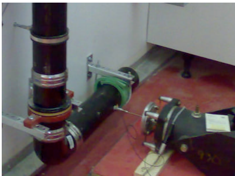
Figur 3. Montage av vibrator, kraftstång och kraftgivare mot avloppsrör av gjutjärn. Rörets horisontella del understöds i änden av ett mycket eftergivligt förband med 12 mm polyuretangummi och en löst åtdragen bygel. Vertikallasten bärs här av två konsoler som skruvats styvt i installationsväggen. Röret stöds även av 2 väggstöd med standard klamsvep.
